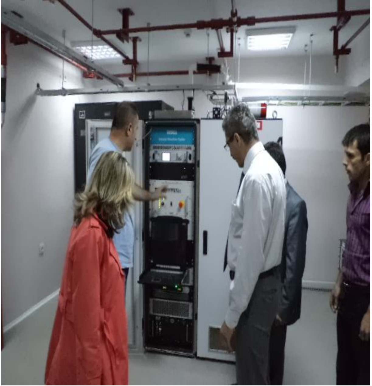
Radar Sistem Odası
